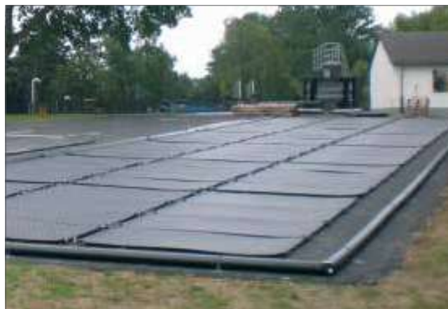
Open ruimte montage
